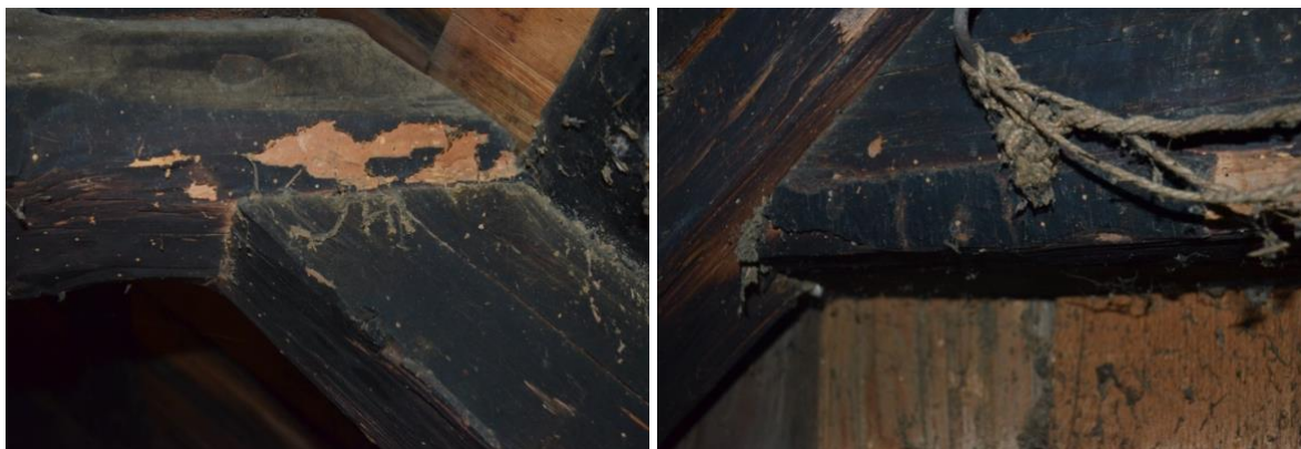
Obr. 18 Detail spojení hambálku a krokev na dřevěný kolík s lokálním poškozením dřevokazným hmyzem tesaříkem krovovým ( Hylotrupes bajulus L.) a červotočem proužkováným ( Anobium punctatum L.).
