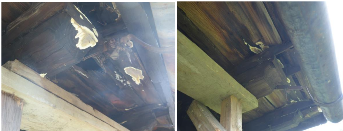
Obr. 12 Detail plodnice dřevokazné houby poprašky sklepní ( Coniophora puteana ) nalezené na JZ stěně ze strany exteriéru.
