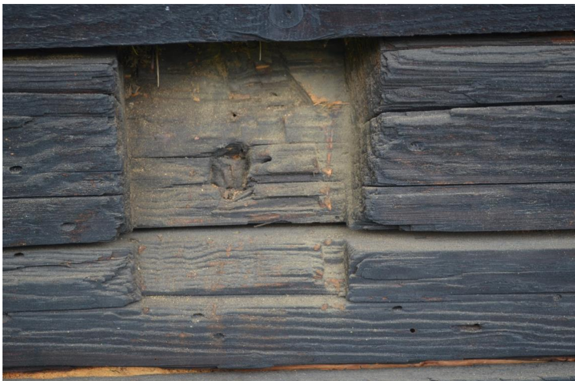
Obr. 26 Dlab po osedlání krokve na prvku roubené JV stěny ze strany exteriéru.
