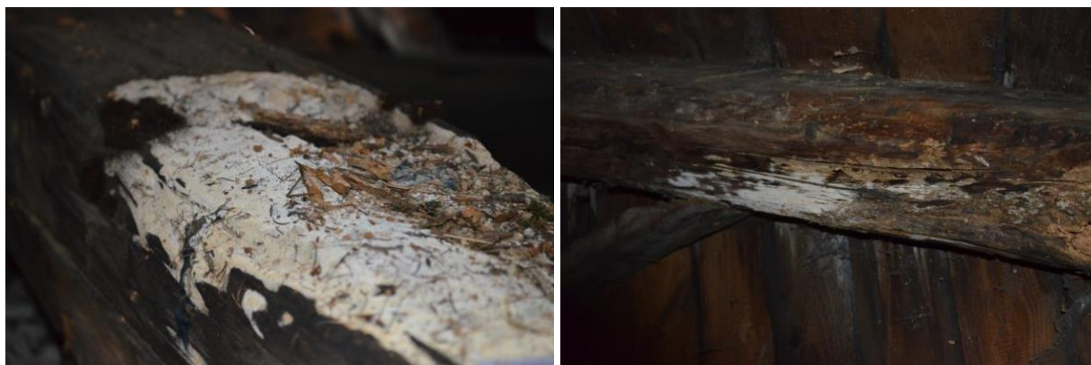
Obr. 13 Poškození dřeva činností poprašky sklepní (Coniophora puteana).
