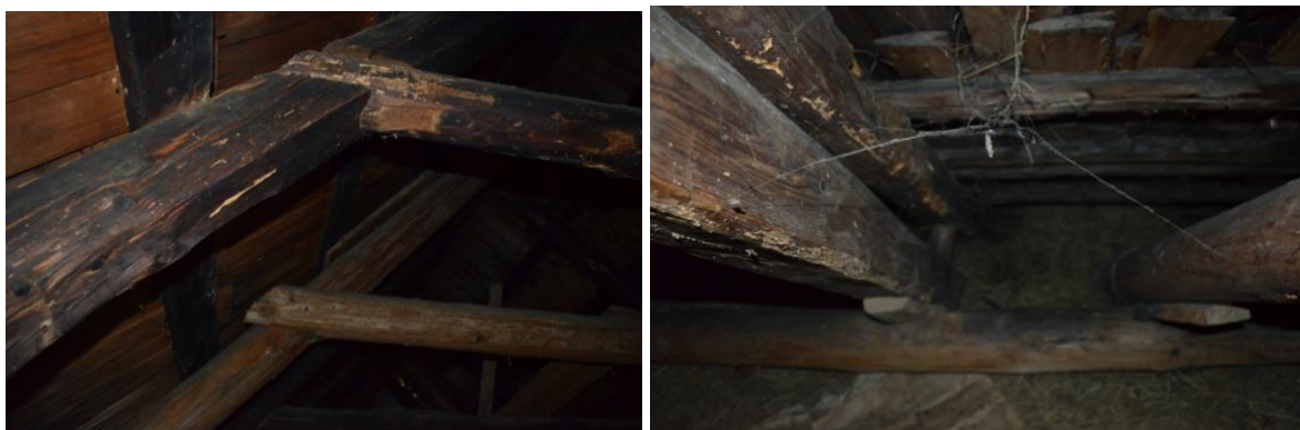
Obr. 17 Degradace krokví, hambálků a námětků dřevokazným hmyzem.
