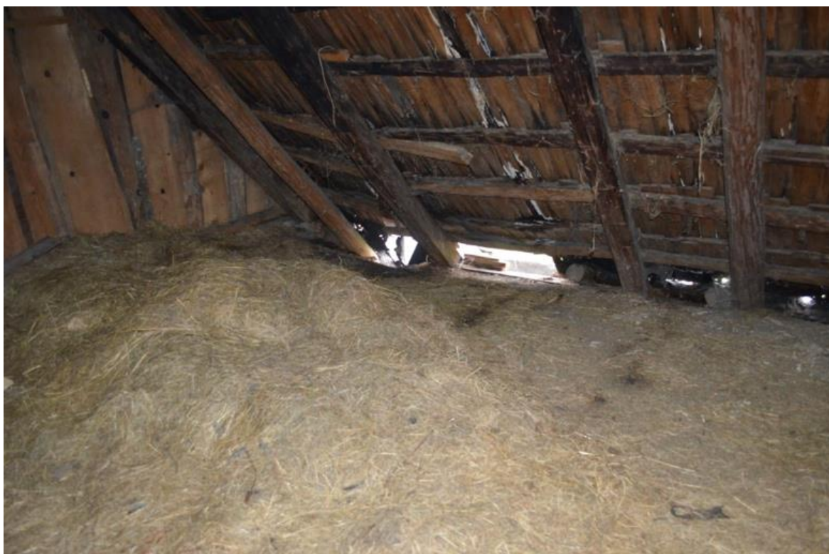
Obr. 19 Poškození střešní roviny dřevokaznou houbou popraškou sklepní ( Coniphora puteana )
