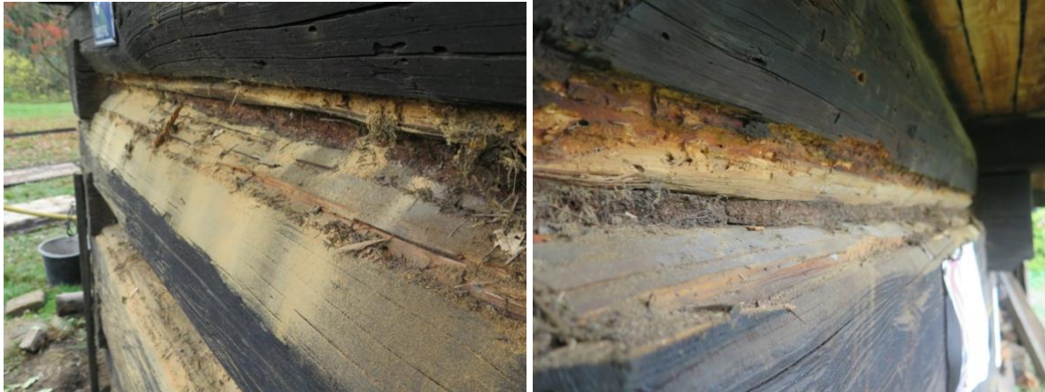
Obr. 2 Detail roubení na JV stěně. Fotka pořízena po demontáži dřevěné lišty a vyjmutí mechu mezi roubením. Patrný dřevní prach, který není způsobený aktivní činností hmyzu. Aktivní hmyz je zjevný pouze v horním prvku roubení a to degradace způsobená tesaříkem krovovým ( Hylotrupes bajulus L.).
