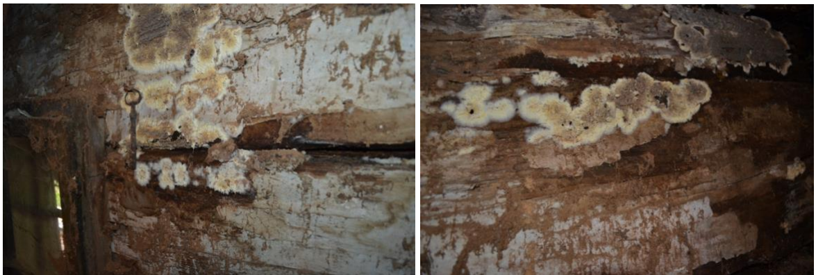
Obr. 7 Detail poškození roubené příčky v komoře na SV straně, prvky rozrušeny činností dřevokazné houby poprašky sklepní ( Coniophora puteana ), vlivem masivního zatékání do konstrukce.
