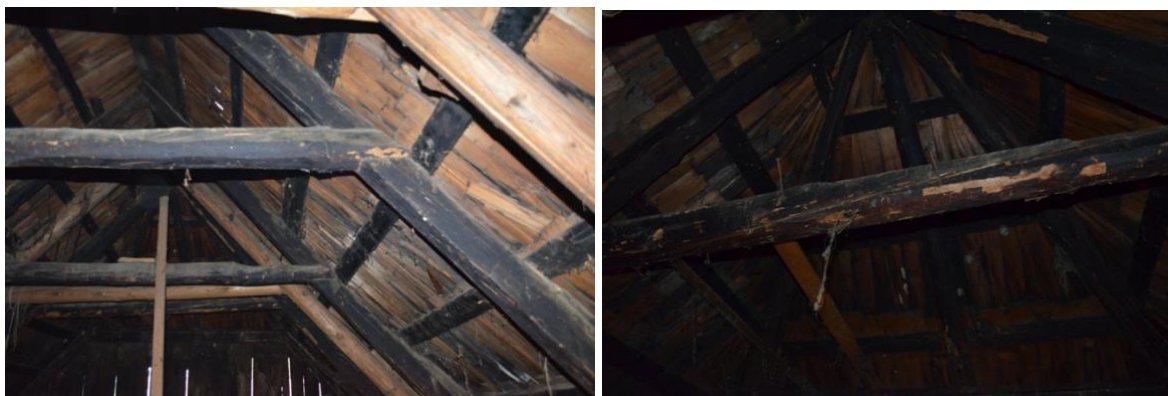
Obr. 15 Vlevo degradace spojení hambálků ke krokví dřevokazným hmyzem a vpravo detail povrchového poškození hambálku.
