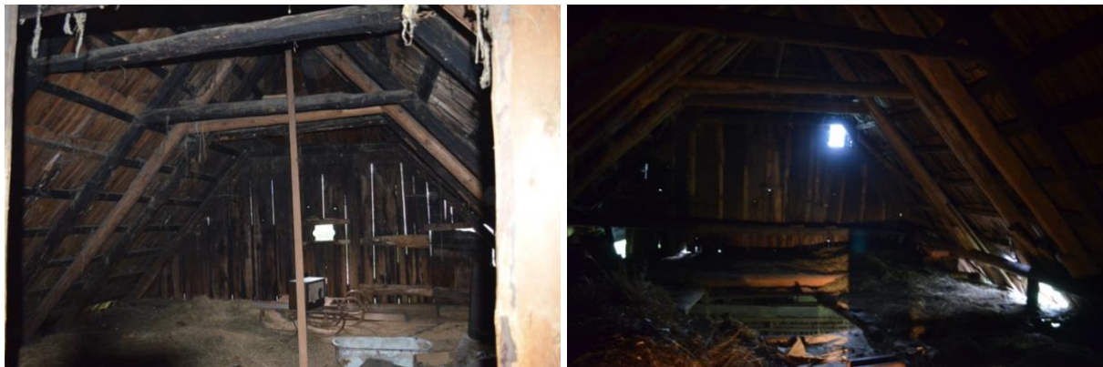
Obr. 7 Pohled do prostoru krovové konstrukce, vpravo krov nad světnicí a vlevo krov nad komorou a chlévem.
