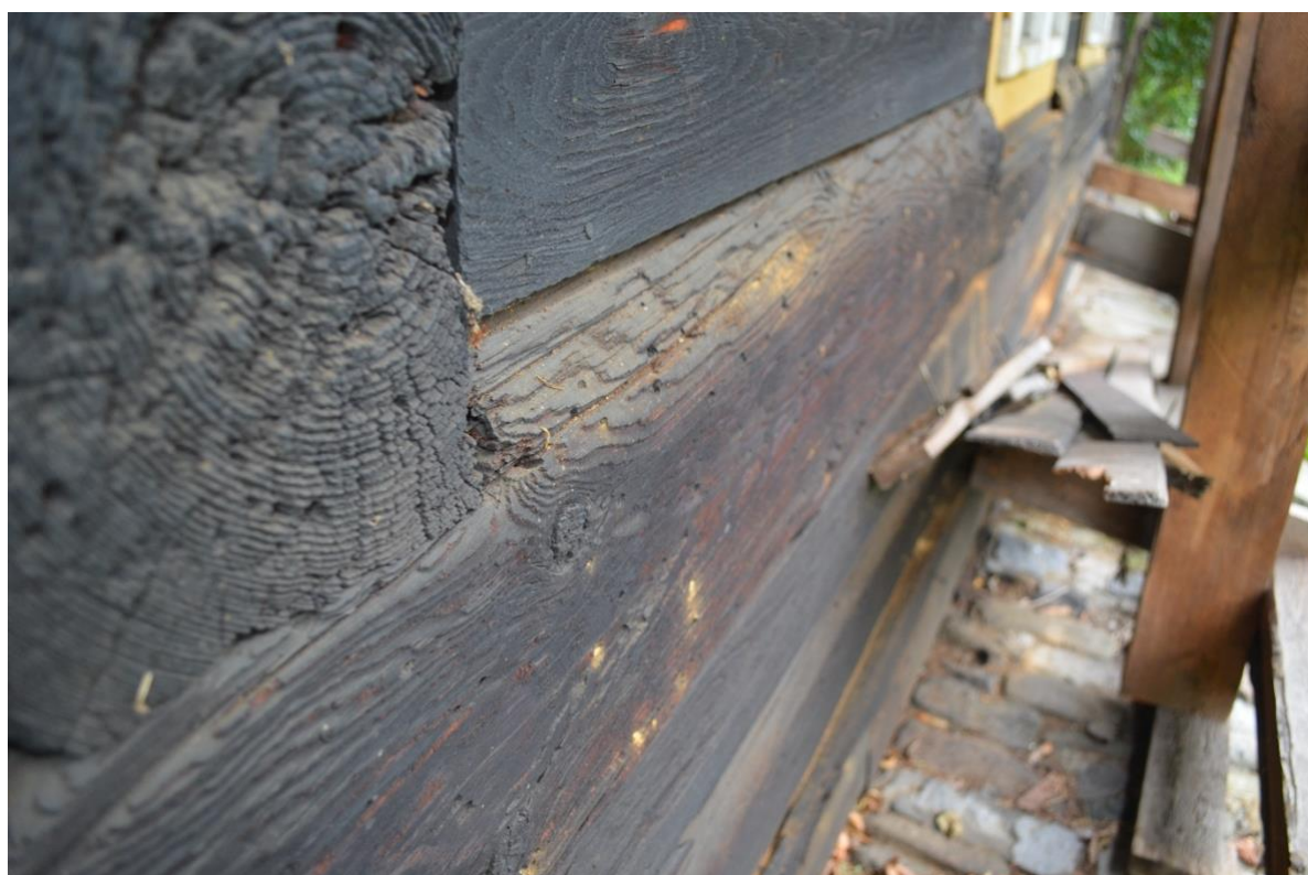
Obr. 1 Detail poškození roubení na JZ straně Poškození tesaříkem krovovým ( Hylotrupes bajulus L.) a lokálně červotočem proužkováným ( Anobium punctatum L.).
