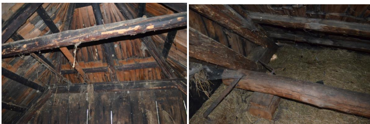
Obr. 14 Degradace hambálku vlevo a vpravo poškození paty krokví a námětků činnosti tesaříka krovového ( Hylotrupes bajulus L.).
