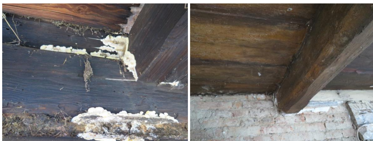
Obr. 21 Detail prvního stropního trámu světnice s plondnicí dřevokazné houby ( Coniophora puteana ). Vlevo pohled ze strany exteriéru a vpravo zhlaví trámu na protilehlé stěně ze strany interiéru.
