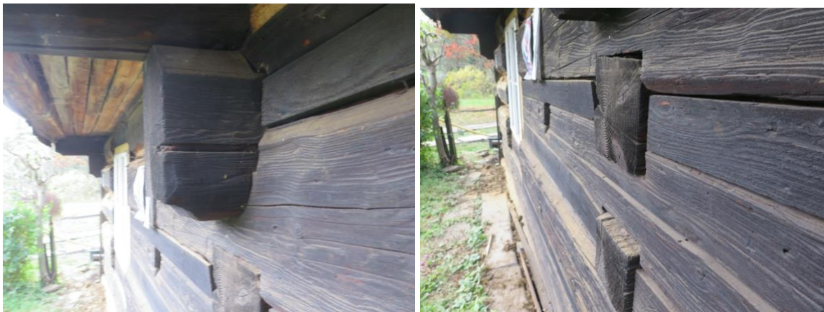
Obr. 3 Detail prvků roubení na JV stěně, bez aktivního poškození dřevokazným hmyzem a houbami.
