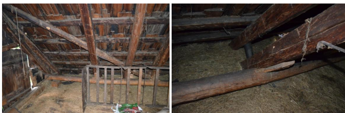
Obr. 16 Poškození krokví činností tesaříka krovového ( Hylotrupes bajulus L.) a červotoče proužkovaného ( Anobium punctatum L.).
